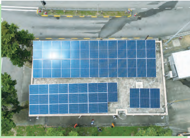
愉景灣隧道設施大樓變電站1號的太陽能板
